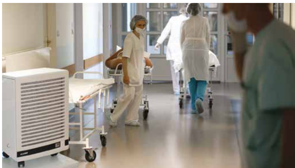
Urządzenie ELIXAIR E400 w szpitalu na korytarzu
