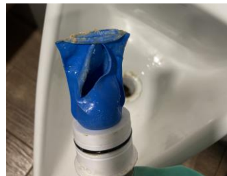
Uszkodzenie mechaniczne lub chemiczne zaworu
