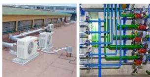
Instalacje klimatyzacji, wentylacji HVAC i wody
